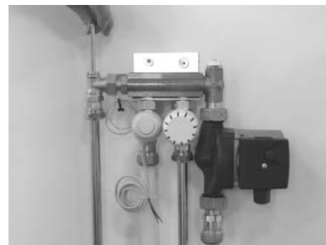
Udbalancering af primærsiden foretages på returløbsventilen.
